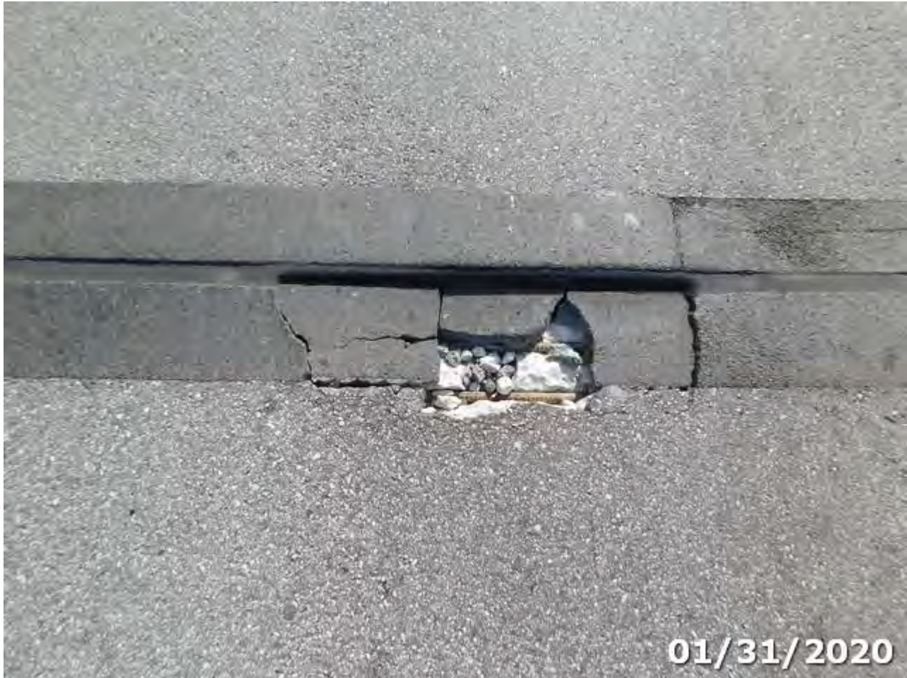
Photo 301-03 (Element/Env 301/4: Pourable Joint Seal)
